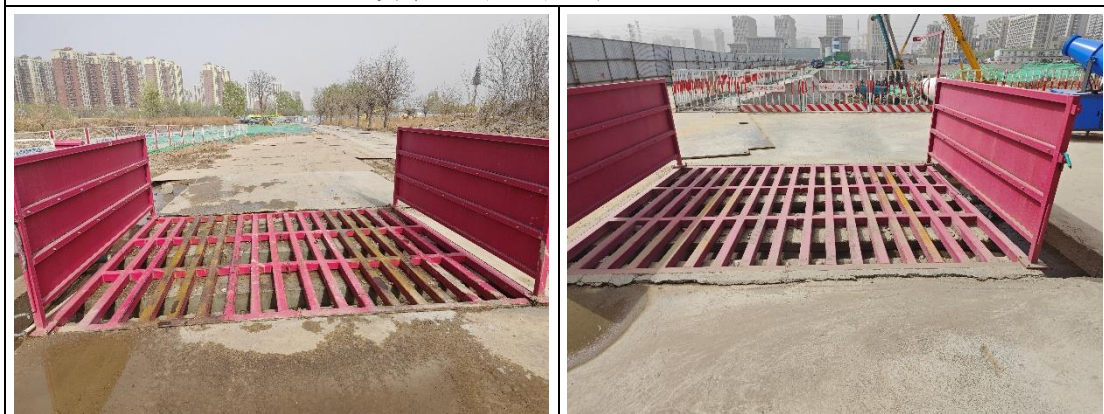
道路管线工程区-临时洗车池 (2023.04)
