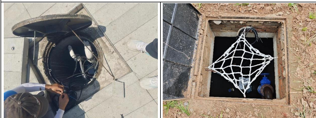
绿化工程防治区-雨水调蓄池 (2025年7月)
