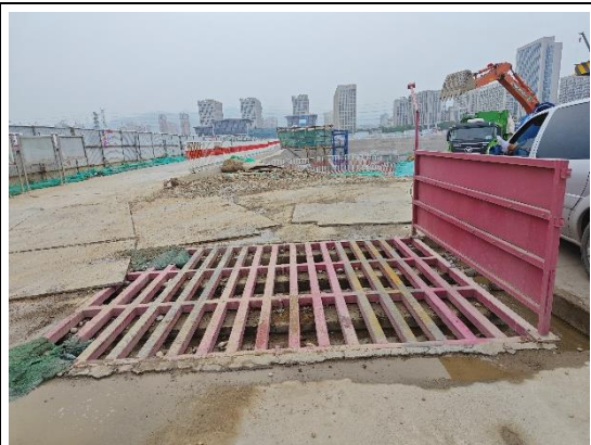
道路管线工程区-临时洗车池 (2023.07)
