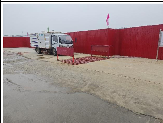
道路管线工程区-临时洗车池 (2024.06)
